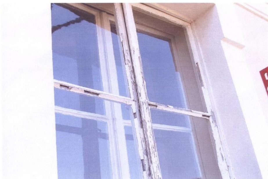
Obr. 21: Poškodené drevené časti okien a chýbajúce vytmelenie v styku so sklenenými tabuľami.
