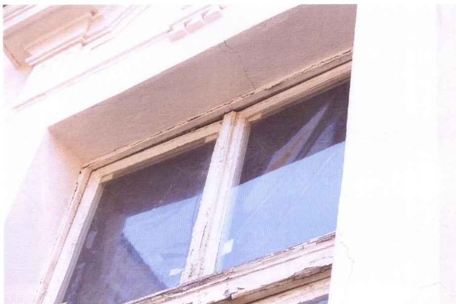
Obr. 22: Havarijný stav okna.
