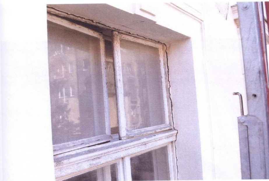
Obr. 25: Havarijný stav ostenia okna s porušením kotvenia okna v obvodovej stene.
