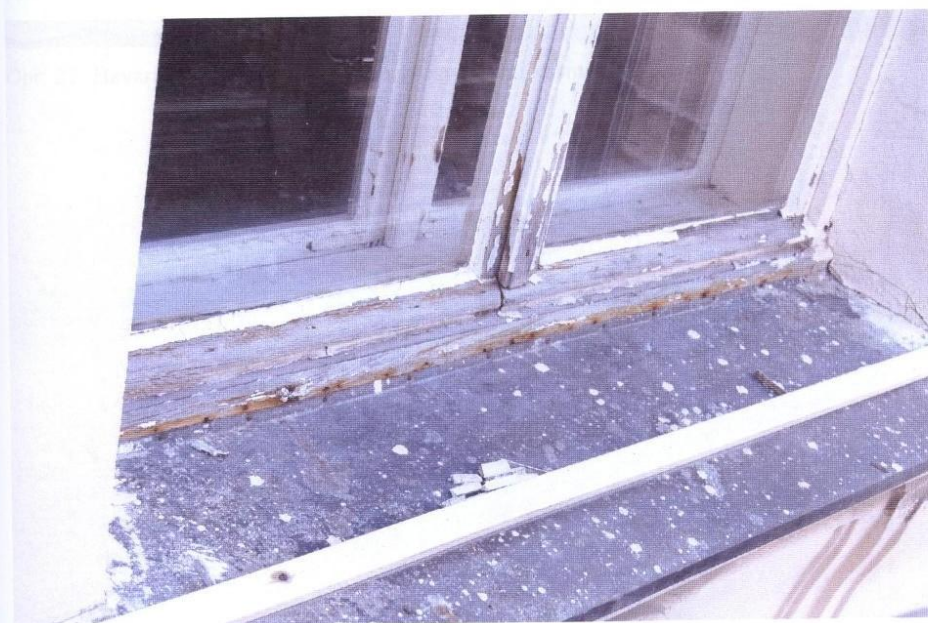
Obr. 26: Havarijný stav oplechovania a drevených častí okna, ktorý je nevyhnutne potrebné sanovať.
