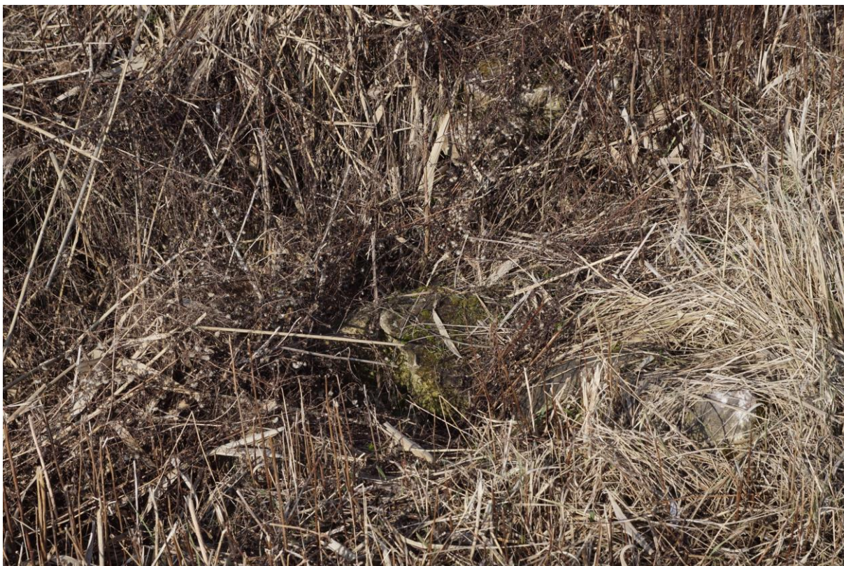
Obr. č. 2. Vyústenie predpokladaného zaneseného priepustu
