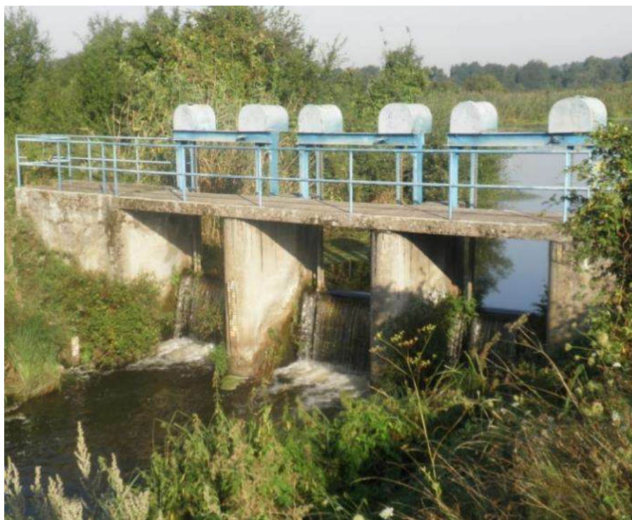
Obr. 3.2 Hlavné stavidlo na haťi Centnůz v km 10,740 Zohorského kanála (foto – Manipulačný poriadok pre vodnú stavbu Hať na jazere Centnůz, SVP, š. p. 2012)
