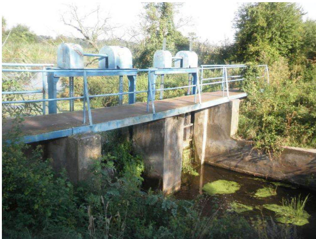
Obr. 3.3 Bočné stavidlo na hati Centnúz v km 12,000 Zohorského kanála (foto – Manipulačný poriadok pre vodnú stavbu Hať na jazere Centnúz, SVP, š. p. 2012)
