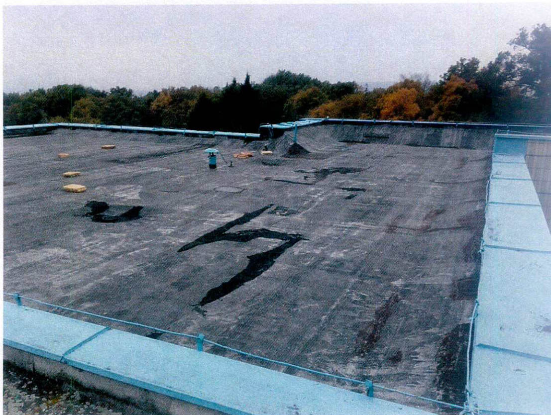
Strešný plášť – poškodenie hydroizolácie
