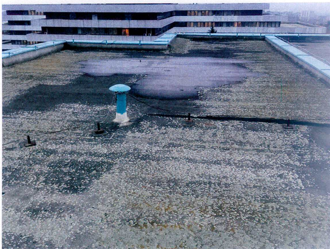
Strešný plášť – povrchové poškodenie hydroizolácie, korózia bleskozvodu
