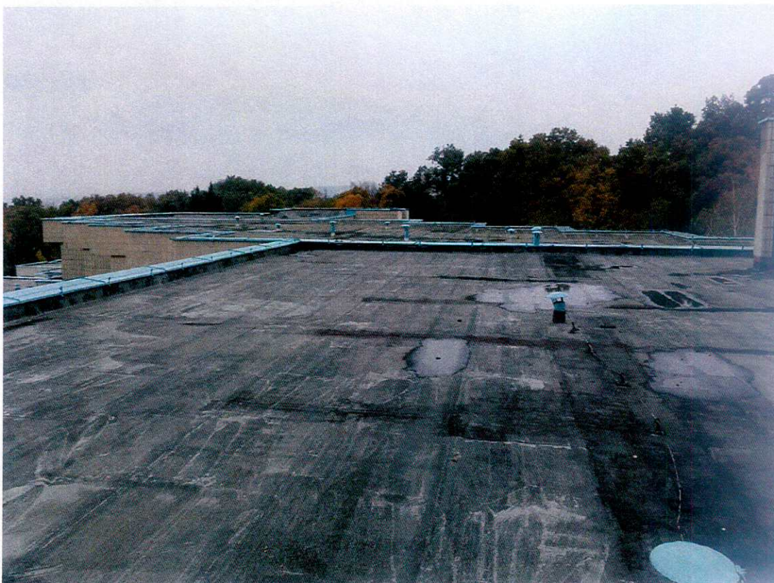
Strešný plášť – povrchové poškodenie hydroizolácie, korózia bleskozvodu
