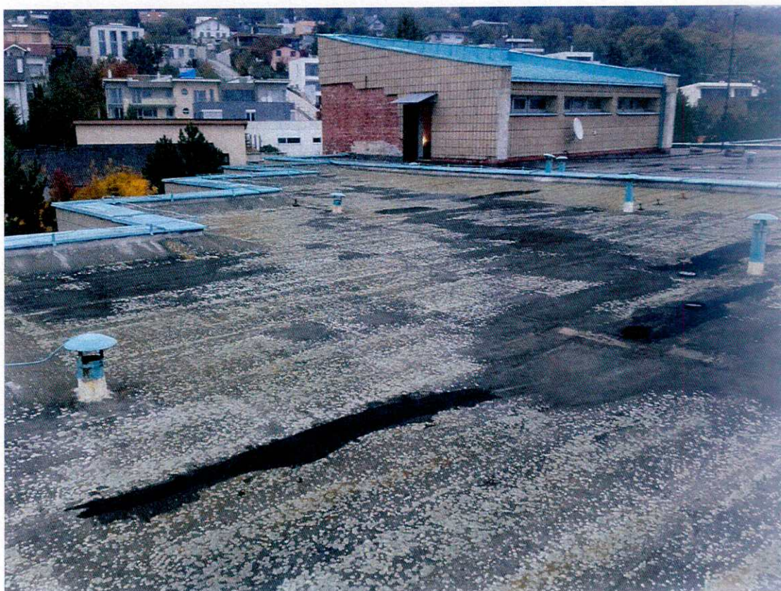
Strešný plášť – povrchové poškodenie hydroizolácie
