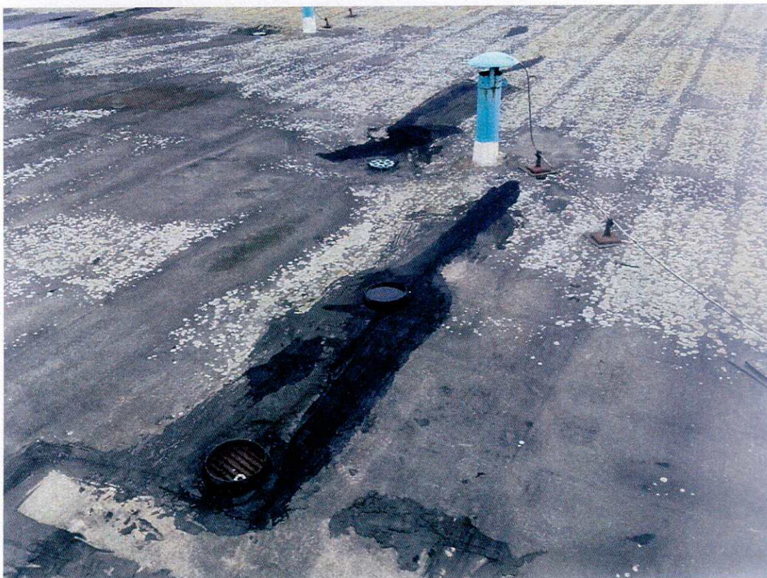
Strešný plášť – praskliny hydroizolácie a vyspravenie
