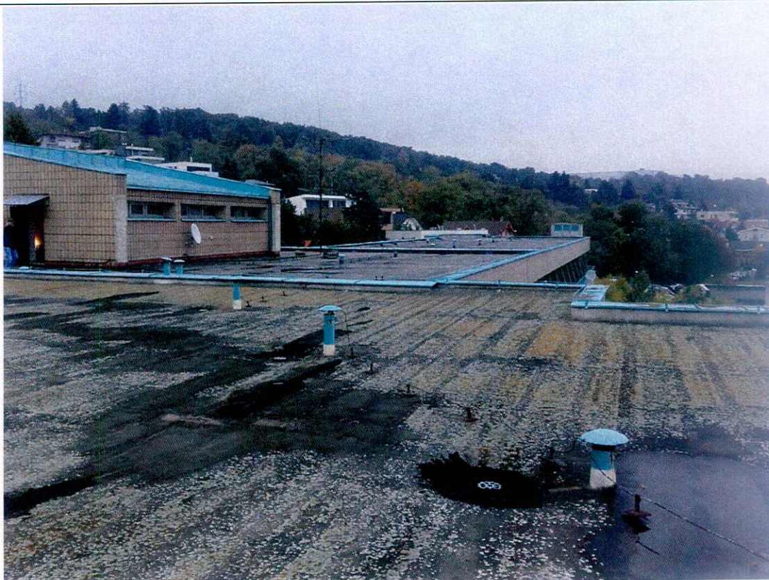
Strešný plášť – povrchové poškodenie hydroizolácie, korózia bleskozvodu
