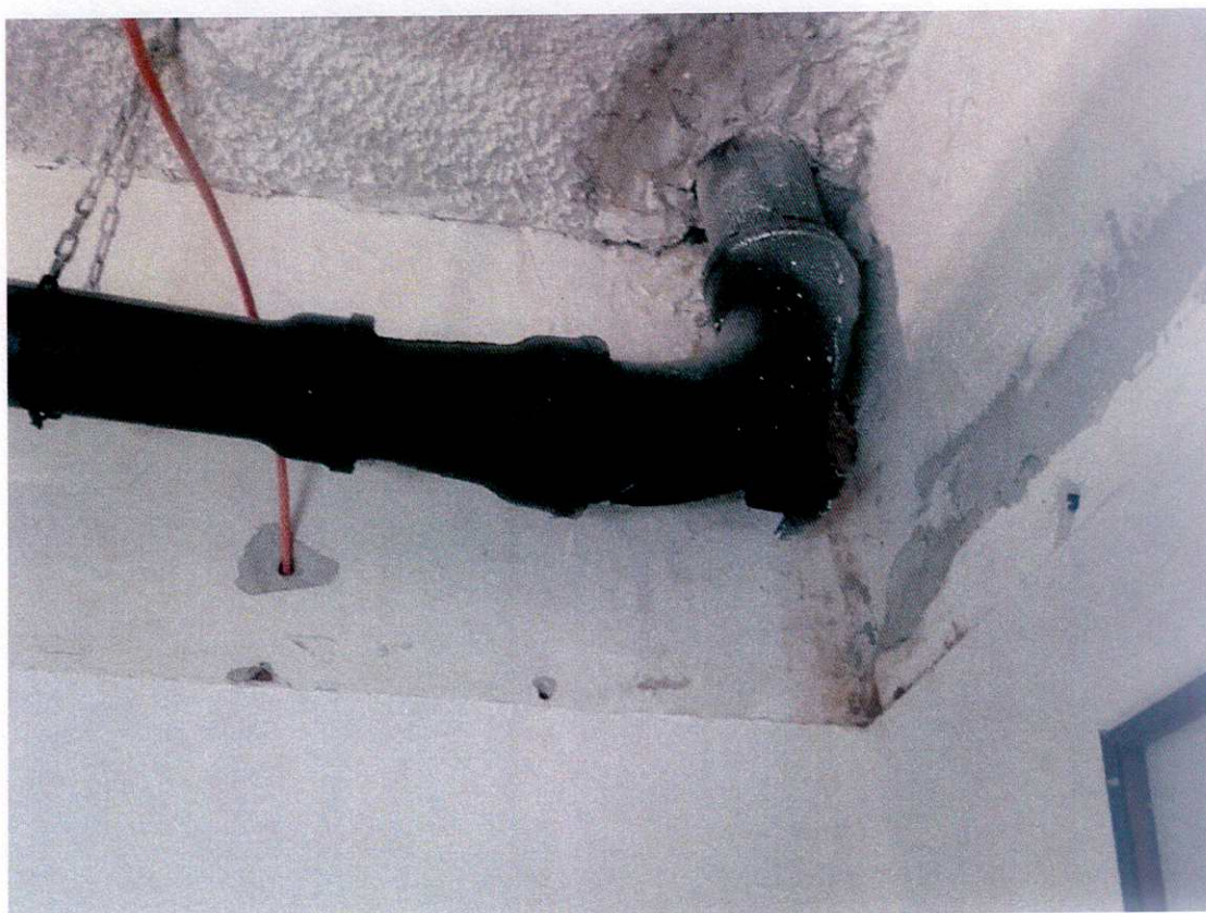
Zatekanie do interiéru
