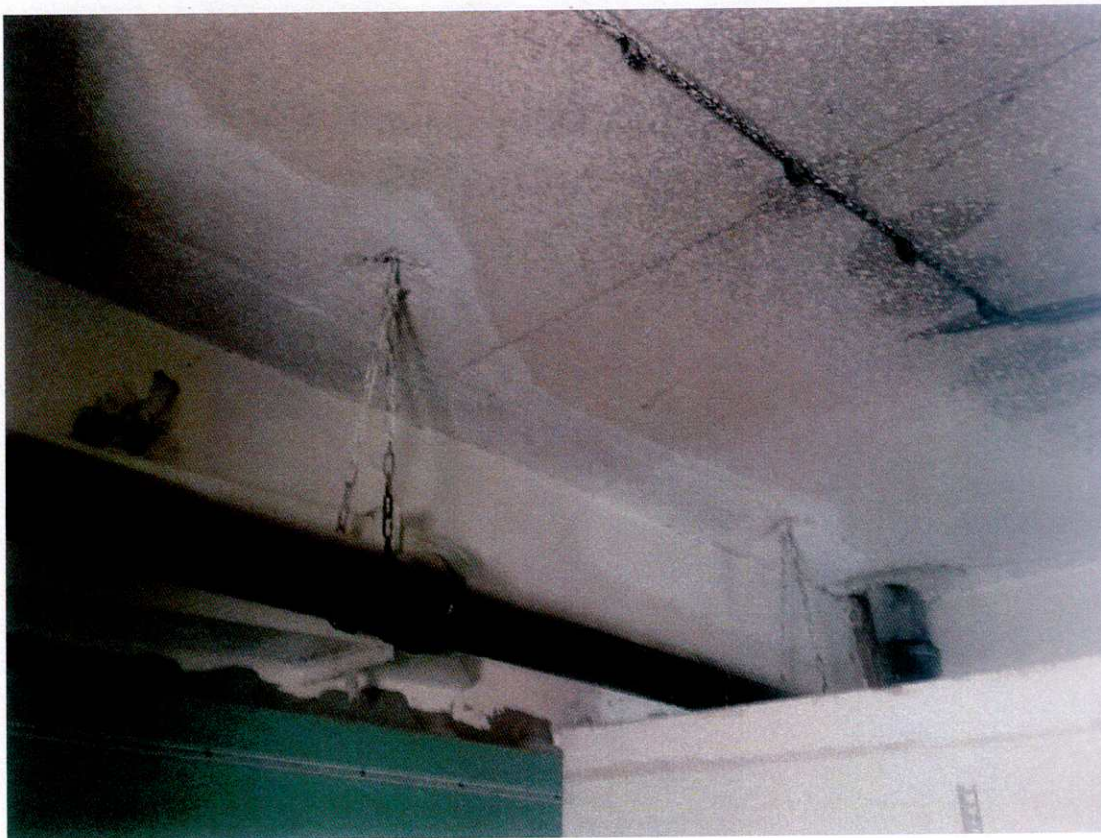
Zatekanie do interiéru
