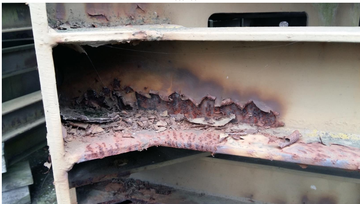
Obr. 3 – Detail povrchovej korózie elementu ŽM 16 v úložisku ÚS STOŽ v Bošanoch
