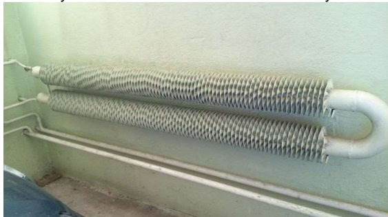
Obr.4 Vykurovacie telesá bez termostaizácie a hydraulického vyregulovania
