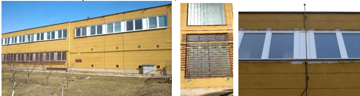
Obr.3 Poškodená fasáda objektu a nadzákladové murivo, copilitová stena
