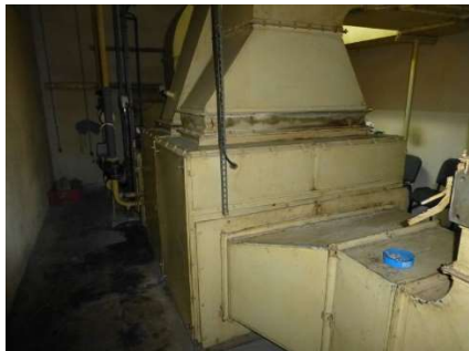
Obr.9 Pohľad na nefunkčnú vzduchotechniku vývarovne
