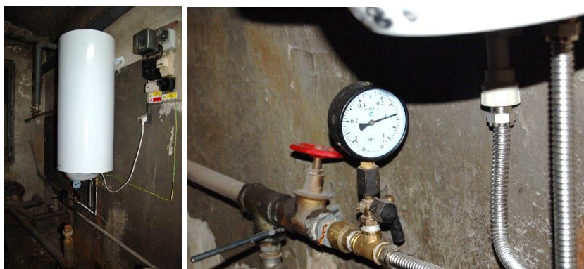
Obr. 32: Ohrev teplej vody
