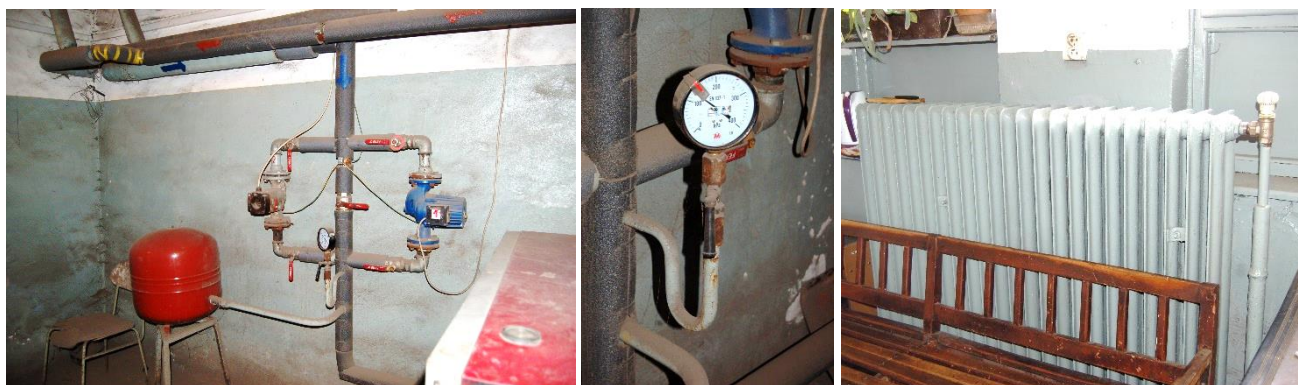
Obr. 56: Vyvedenie a odovzdávanie tepla
