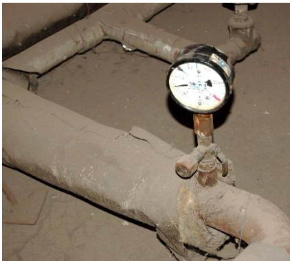
Obr. 12: Vyvedenie a odovzdávanie tepla
