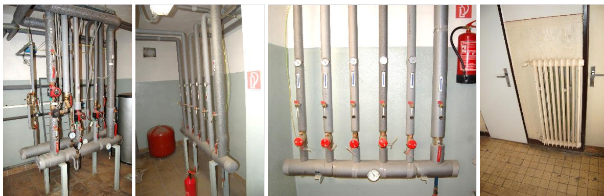
Obr. 40: Vyvedenie a odovzdávanie tepla
