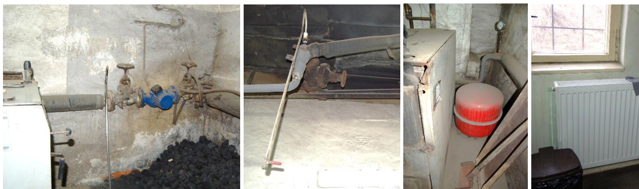
Obr. 18: Vyvedenie a odovzdávanie tepla
