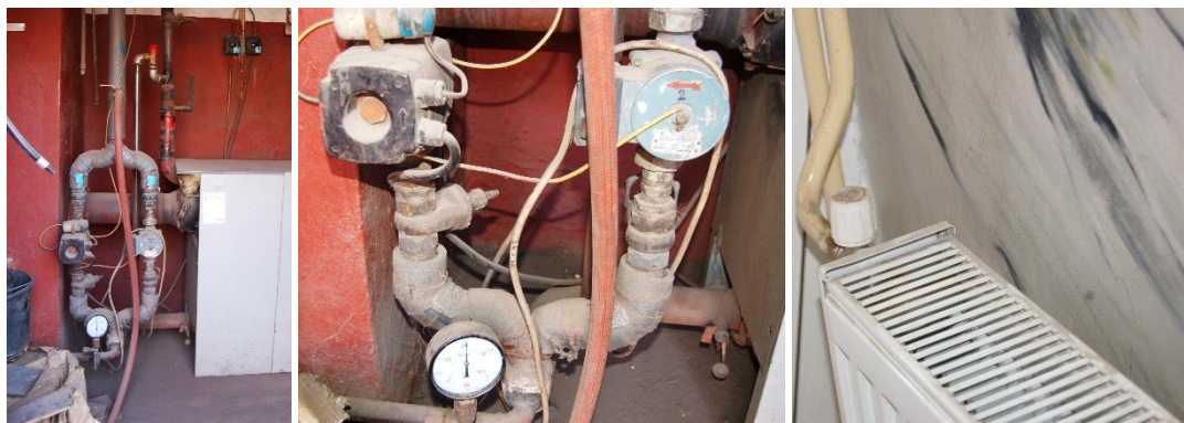
Obr. 5: Vyvedenie a odovzdávanie tepla
