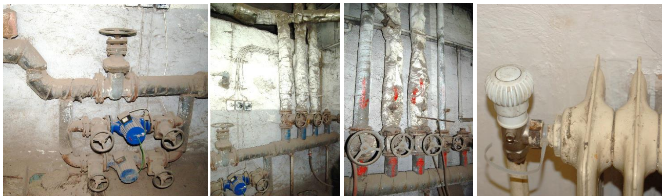
Obr. 24: Vyvedenie a odovzdávanie tepla
