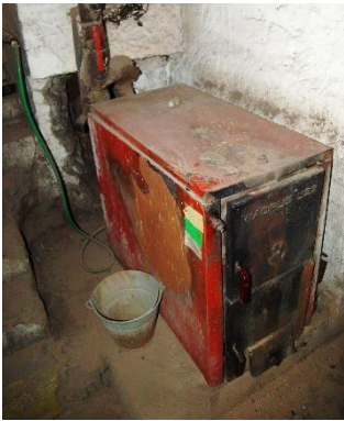
Obr. 48: Inštalovaný kotol - pôvodný
