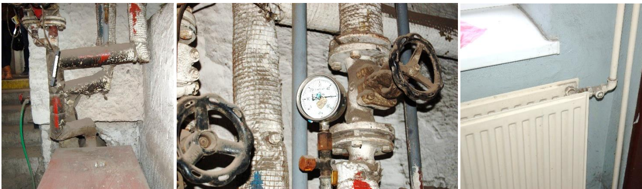
Obr. 49: Vyvedenie a odovzdávanie tepla
