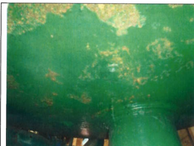
Obr. 5 – stav spodných klenutých dien filtrov
