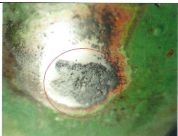
Obr. 6 – detail korózneho poškodenia
