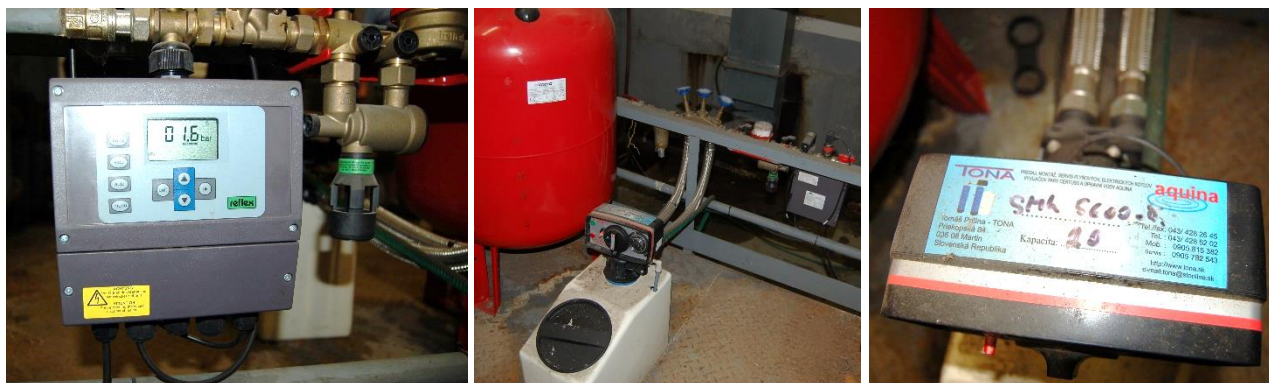
Obr. 11: Úprava vykurovacej vody
