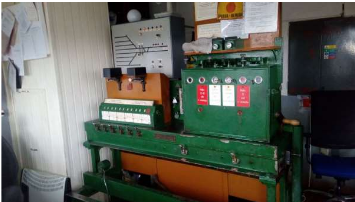
6. Stavadlový prístroj St.2 ŽST Pribeník
