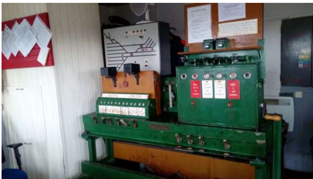
5. Stavadlový prístroj St.1 ŽST Pribeník
