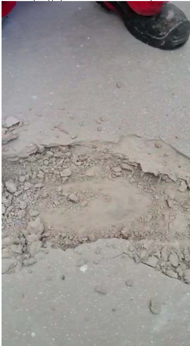
Foto pôvodného podkladu po odstránení vrchnej škrupinovej vrstvy betónu
