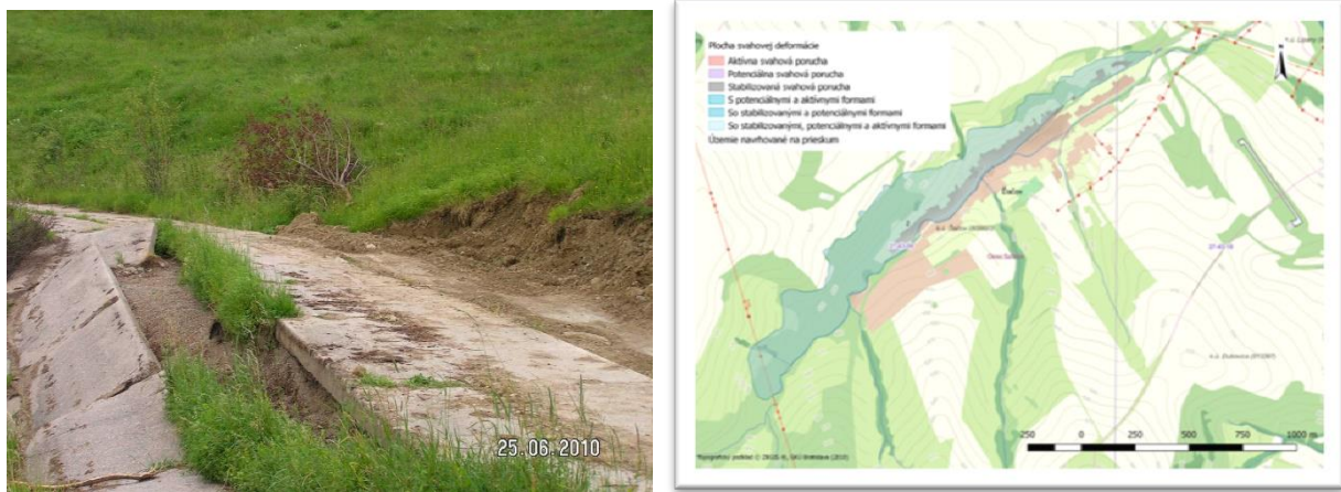
Obr. 3: Havarijná svahová deformácia Ďačov (zdroj: Databáza ŠGÚDŠ)
