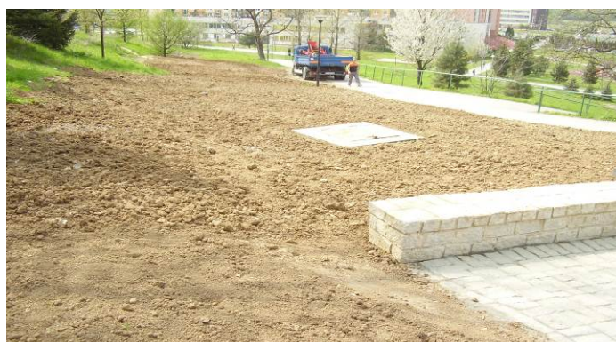
Fontána Agelina - technologická šachta
