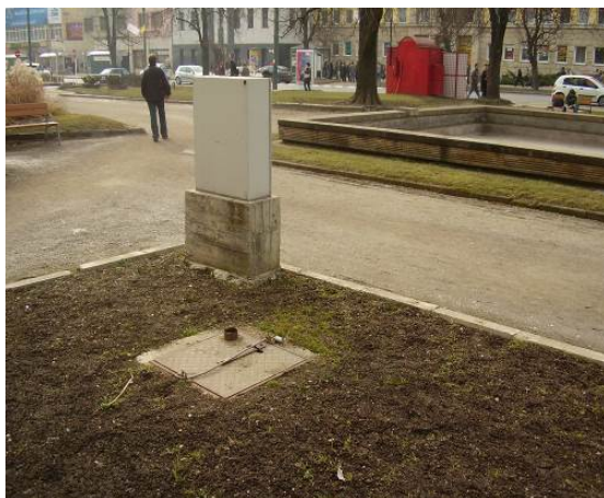
Fontána Divízia - elektrický rozvádzač a šachta
