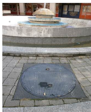
Fontána Šváby - technická šachta
