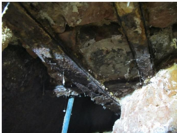
Obr.15.: preklady prielezov do prietahov – oceľové profily sú značne skorodované
