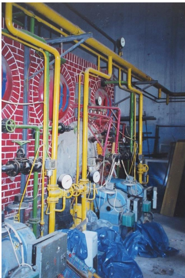
Obr.9.: kotolňa po plynofikácii; zdroj: MIB
