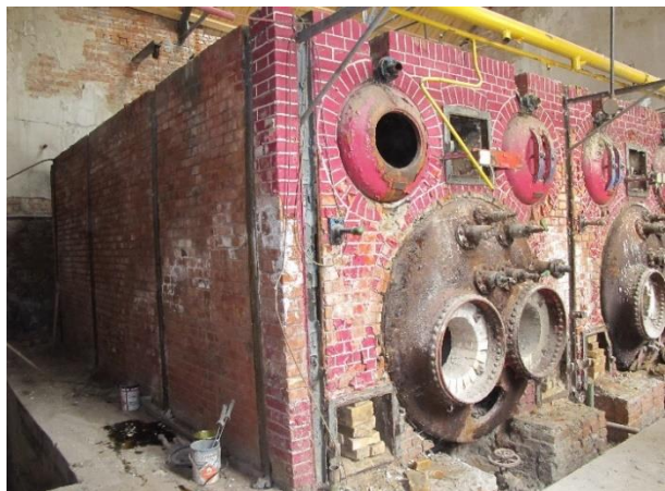
Obr.14.: na obmurovke sú jasne viditeľné vyzrážané soli, spony sú značne skorodované najmä na úrovni podlahy
