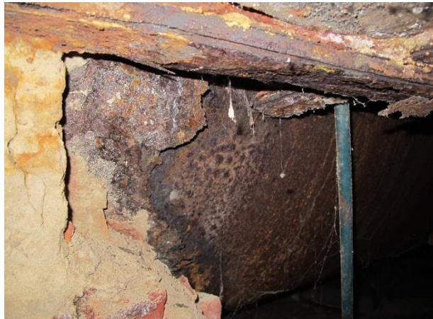
Obr.12.: korózia je obzvlášť rozsiahla v stykoch kovových plôch s obmurovkou
