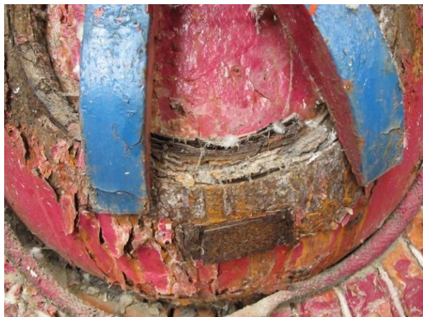
Obr.13.: pravý varník pravého kotla je obzvlášť degradovaný koróziou
