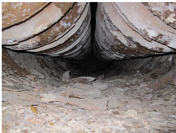
Obr.11.: vodný priestor kotlov je zanesený silnou vrstvou vodného kameňa
