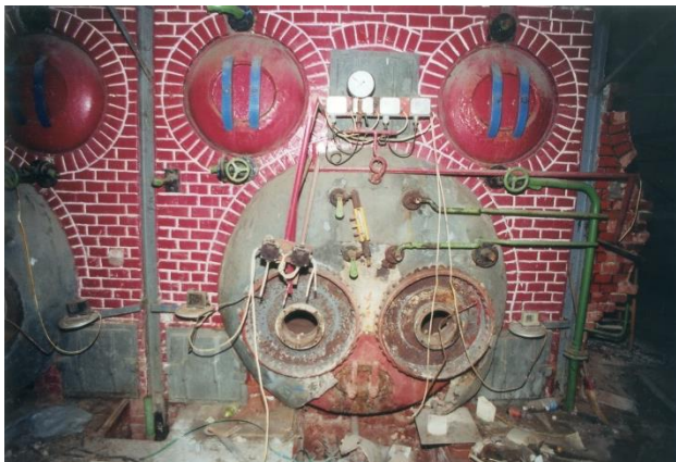
Obr.10.: stav kotlov v roku 2002; zdroj: PÚ SR
