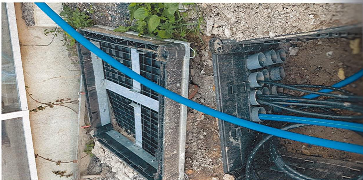
3x záber vonkajšej káblovej šachty – západná strana budovy žst. Štrba
