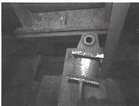
Obr. 6 – Porucha 2, deformácia a trhliny
