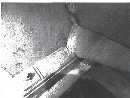
Obr. 7 – Porucha 3, trhliny (výstuha potrubia)
