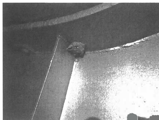
Obr. 14 – Porucha 5, trhliny (výstuha diafragmy trámu)
