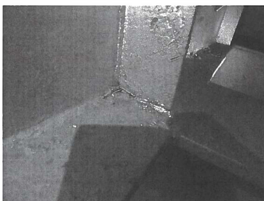
Obr. 8 – Porucha 3, trhliny (výstuha diafragmy trámu)
