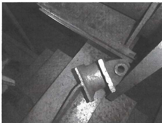
Obr. 4 – Porucha 1, deformácia a trhliny
