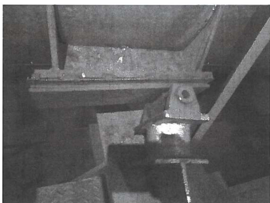
Obr. 5 – Porucha 2, deformácia a trhliny
