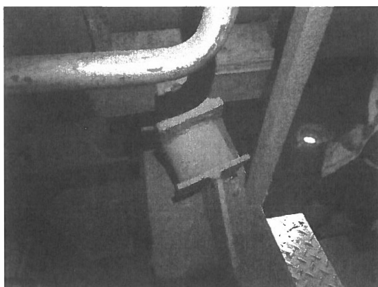
Obr. 11 – Porucha 4, deformácia a trhliny
