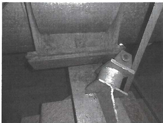
Obr. 3 – Porucha 1, deformácia a trhliny
