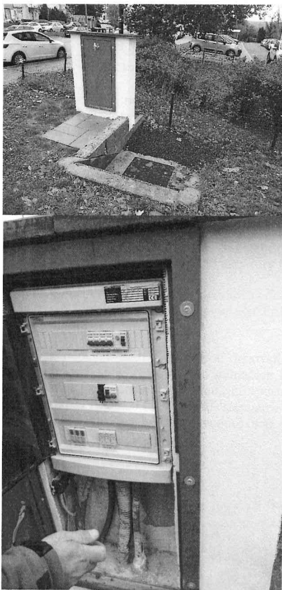
Obr.13. č. Skriňa elektrických rozvádzačov vedľa vodovodnej šachty s vodomerom a solenoidmi pre dopĺňanie vody.
