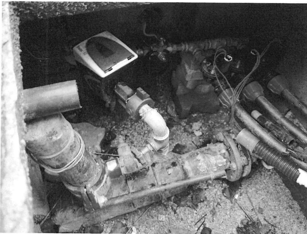
Obr. č.12. Vodovodná šachta na ul. H Meličkovej s vodomermom na potrubí BVS, guľovými uzávermi, s prípojkou na kompresor a 3x solenoidmi pre dopĺňanie troch podzemných nádrží.
