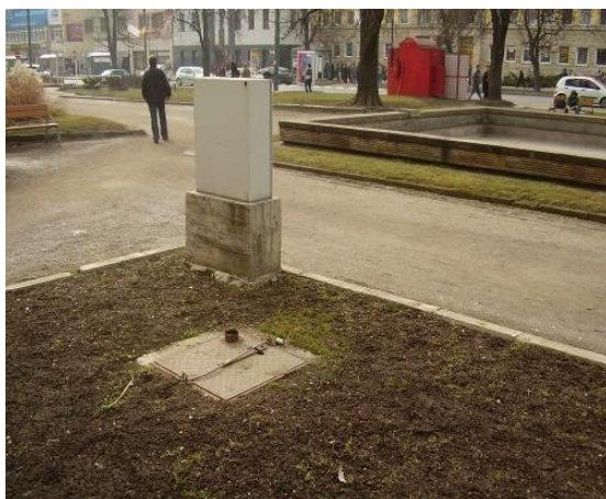
Fontána Divízia - elektrický rozvádzač a šachta
