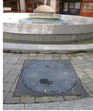
Fontána Šváby - technologická šachta
