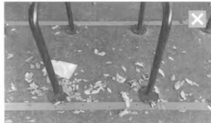
24 Nevhodné povrchové kotvenie cyklostojanov skrutkovým ocelovým pátkom do asfaltu v kombinácii s navarenými pásovínami.
