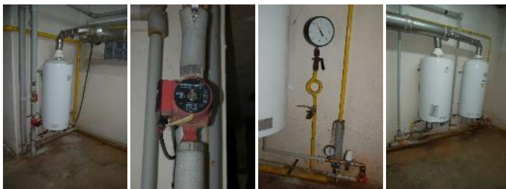
Obr. 38: Vyvedenie TV – kotolňa
