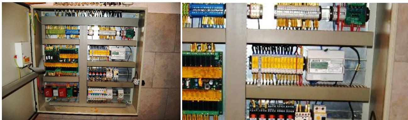
Obr. 28: ELM1 – Meranie spotreby elektriny pre chod kotolne
