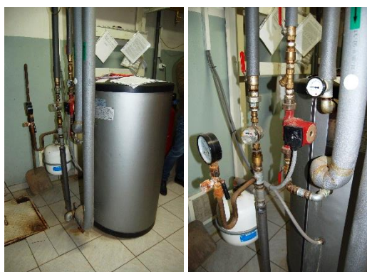
Obr. 8: Vyvedenie TV - kotolňa
