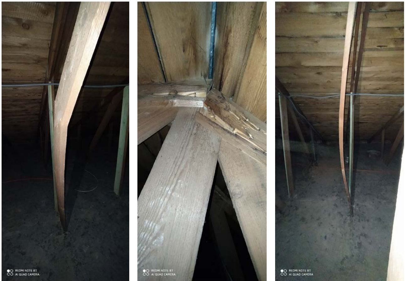
Obr. 5-6-7: prasknutá diagonála, zatečená a prasknutá horná pásnica, vybočená diagonála
