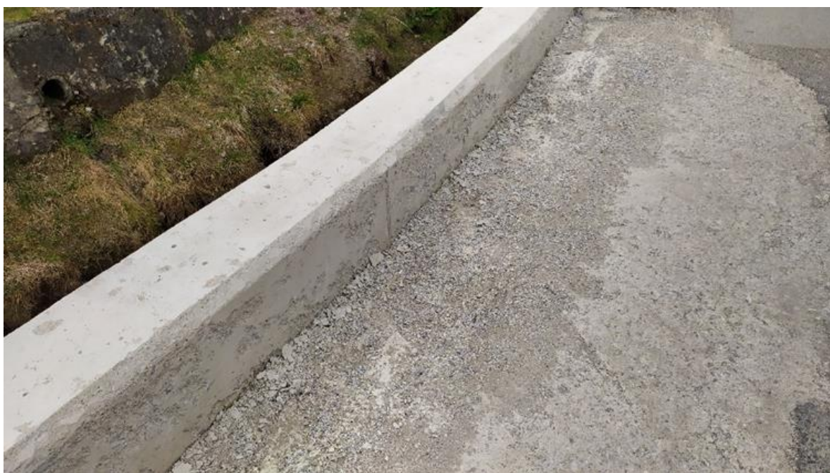
Stav vozovky pri OM
